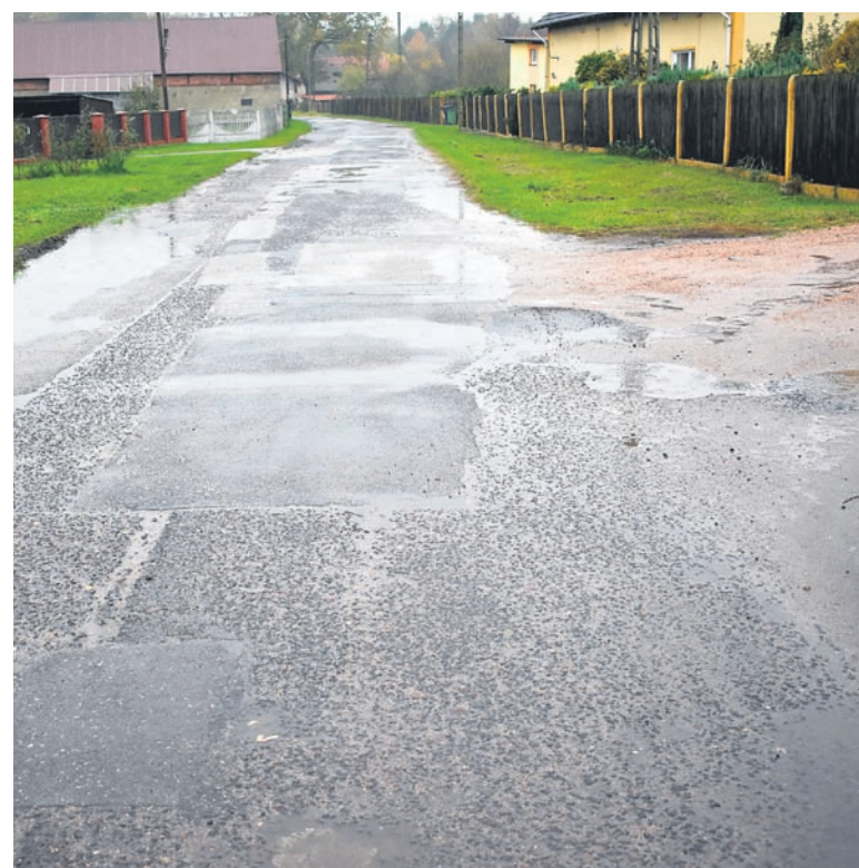
Część nawierzchni na ul. Zamoście.
