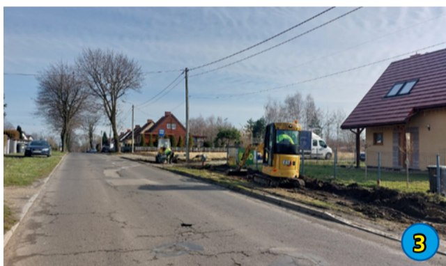
3. BUDOWA I MODERNIZACJA EFEKTYWNEGO ENERGETYCZNIE OŚWIETLENIA DROGOWEGO W GMINIE ŁĘDZINY - 4 432 771,50 ZŁ
