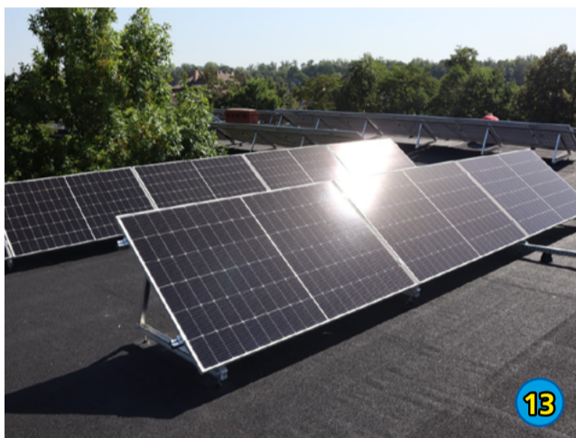
13. ZABUDOWA SYSTEMU ODNAWIALNYCH ŹRÓDEŁ ENERGII W BUDYNKU SZKOŁY PODSTAWOWEJ NR 3 W ŁĘDZINACH - 248 773,20 ZŁ
